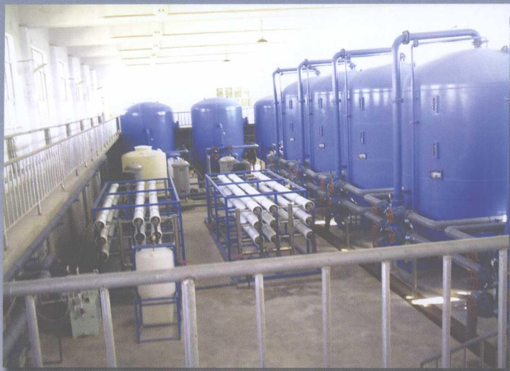
额肯呼都格镇供水工程水处理车间
