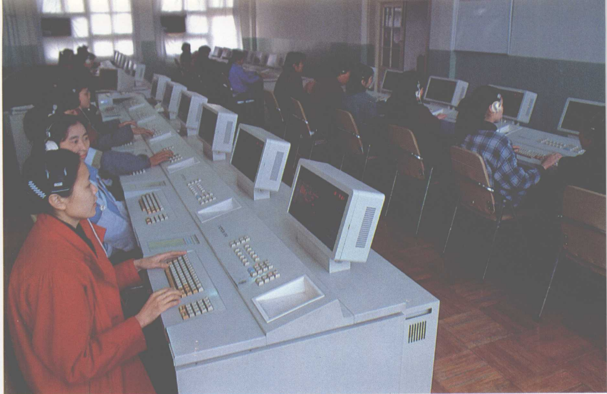
福州程控电话无绳台操作室
