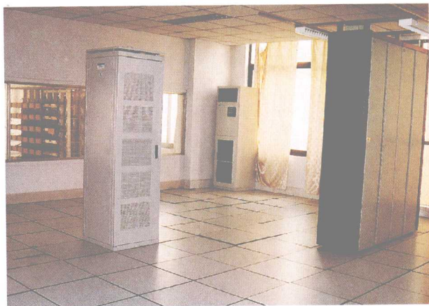
电信交换设备
