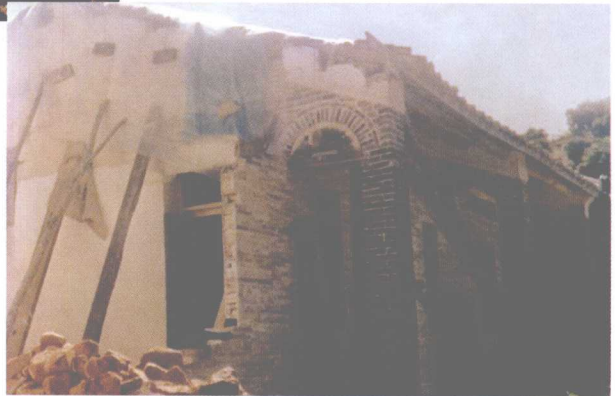
8604 号热带风暴中琼海遭严重破坏的民房
