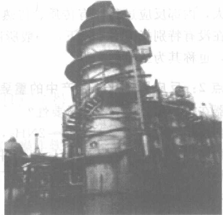
(d) 固定床反应器(一氧化碳变换炉)
