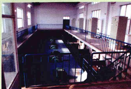
西段村水库送水站电机
