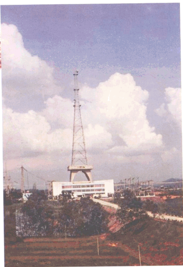
平果 50 万伏超高压变电站
