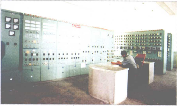
阔克苏水电站主控机房
