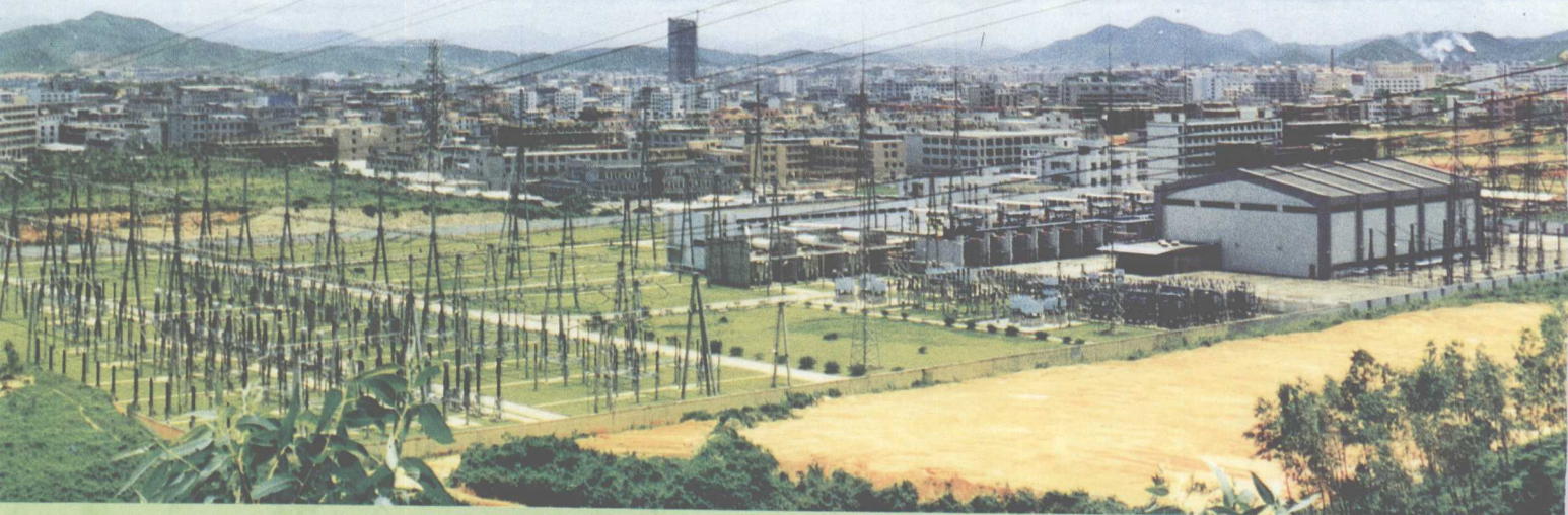
深圳市最高电压等级的变电站——500 千伏深圳变电站
