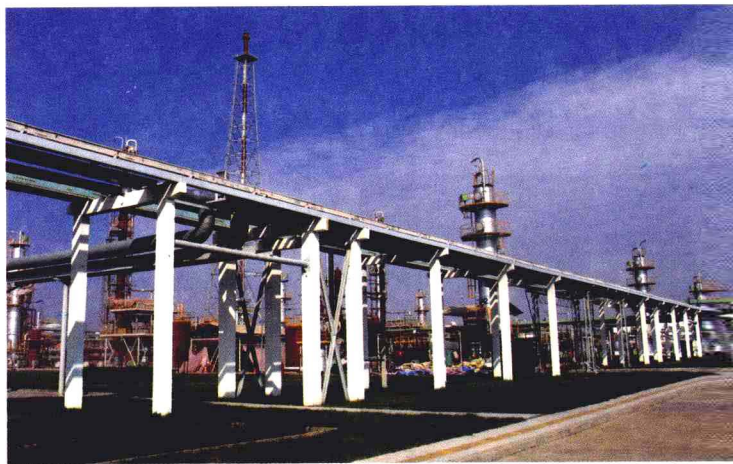
西气东输陕北段，长庆气田第一净化厂。
