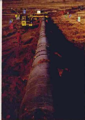
西气东输巨大钢管的修建是为了把中国西部地区的天然气输送给东部地区。
