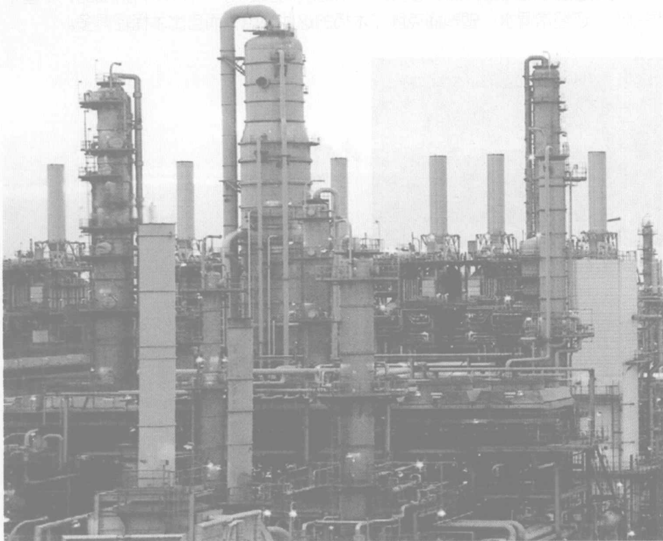
图8 石油化工生产设备
