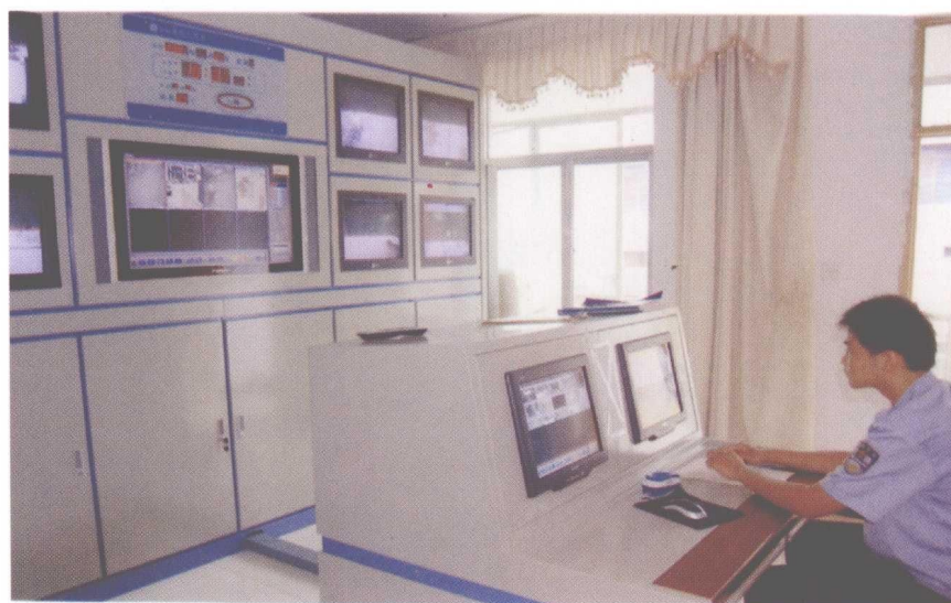
▶ 治安巡防监控室
