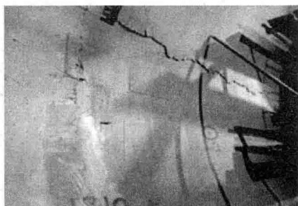
图 1.3 隧道变形致使衬砌开裂
