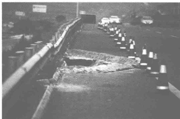
图 1-1 甘肃天定高速公路坍塌 [1]
