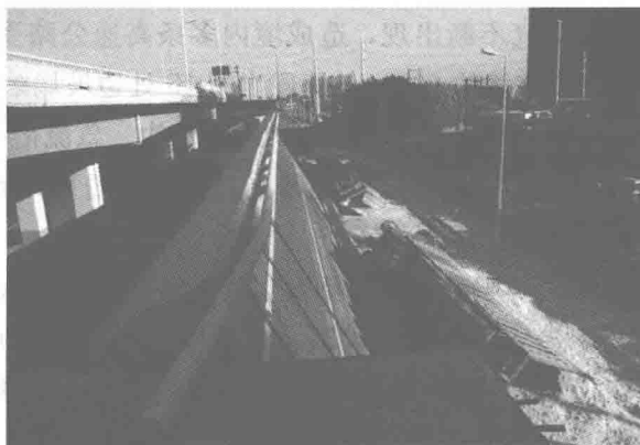
图 1-3 哈尔滨阳明滩大桥坍塌全景 [2]
