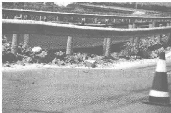
图 1-2 甘肃天定高速公路塌陷 [1]
