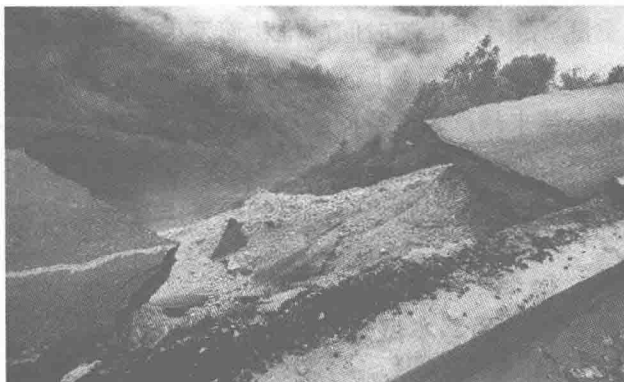
图 1-5 云南省公路坍塌事故 [3]
