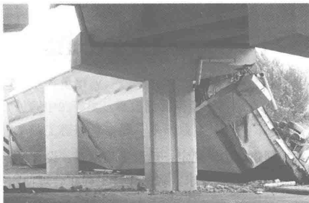
图 1-4 哈尔滨阳明滩大桥坍塌局部 [2]
