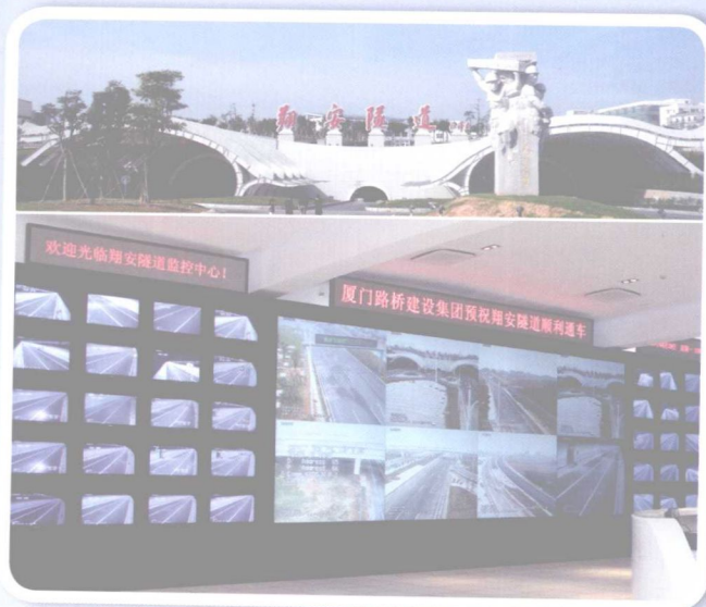
厦门翔安隧道机电与防灾系统
