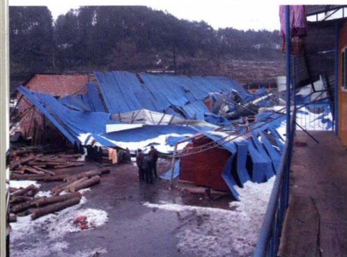
被冰雪压塌的金威人造板厂车间
