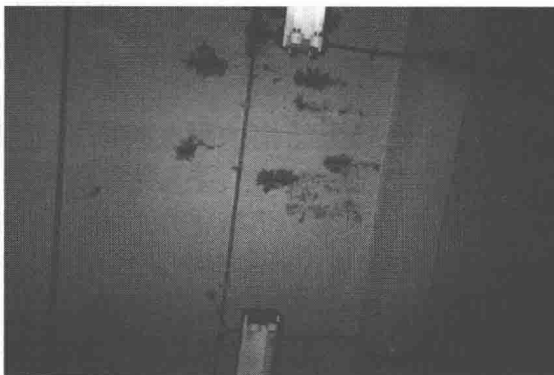
图 1.1 某人防地下室顶板钢筋锈蚀
