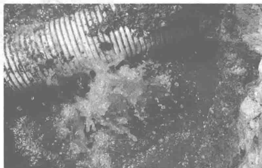
(a) 管道漏水
