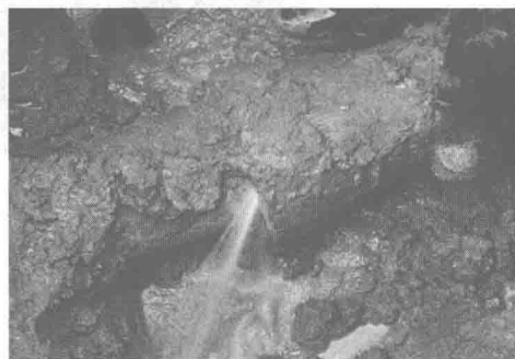
(b) 管道断裂
