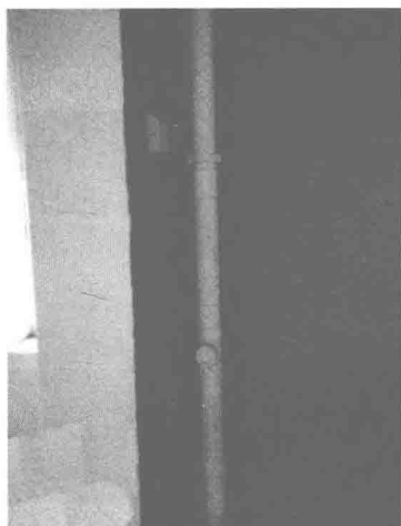
(b) 立管安装距墙过远
