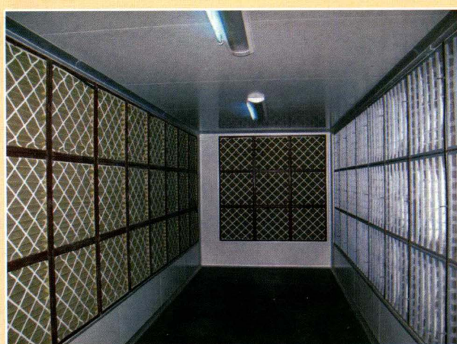
公猪站洁净室（左边 为初效过滤墙，右边 为亚高效过滤墙）
