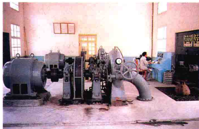
八〇电站机房
