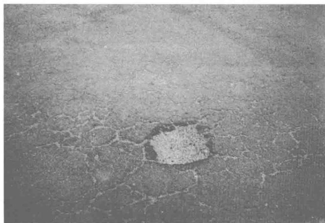
图 2-1 原路面破坏状况
