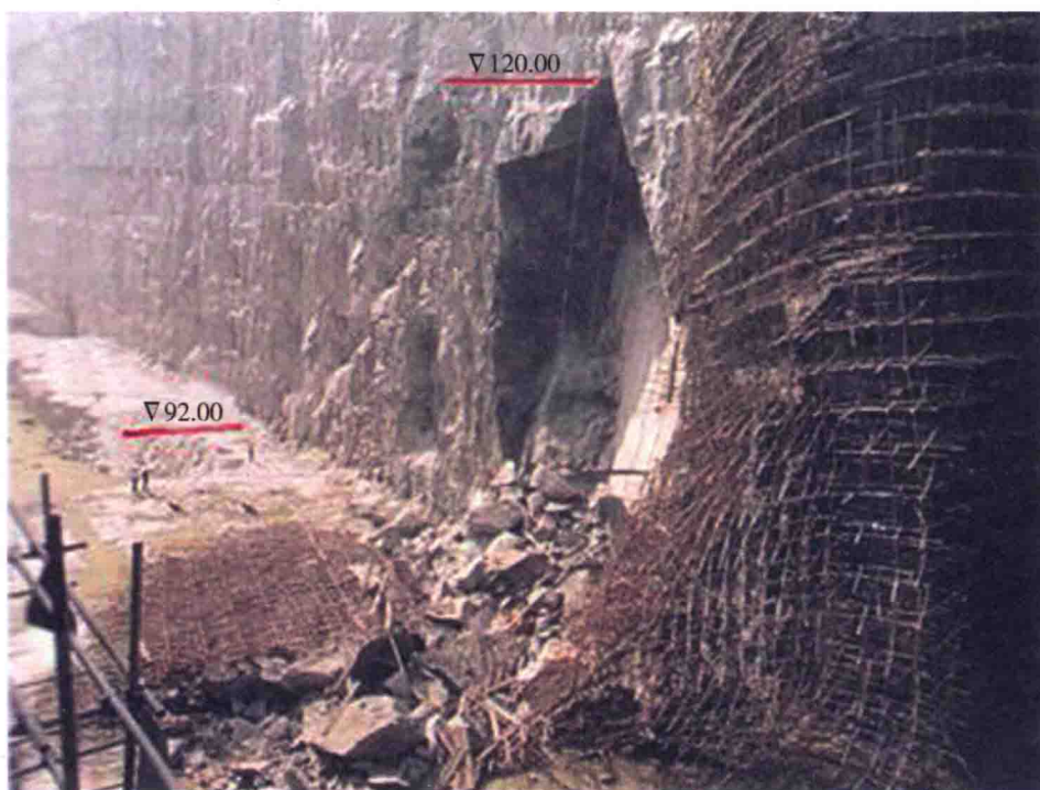
图 1.2 船闸开挖过程中的一处块体垮落
