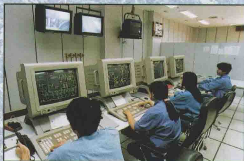
上海水泥厂 2000吨干法窑中央控制室
