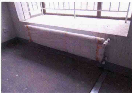
图 1-16 不能随意改动暖气管道
