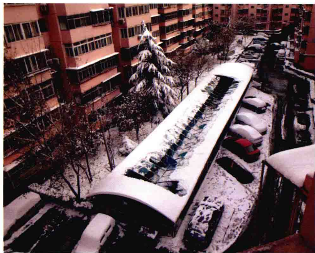
被大雪压塌的车棚
