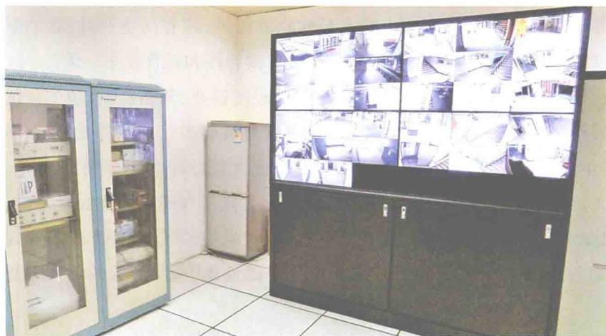
更新后的馆内监控设备
