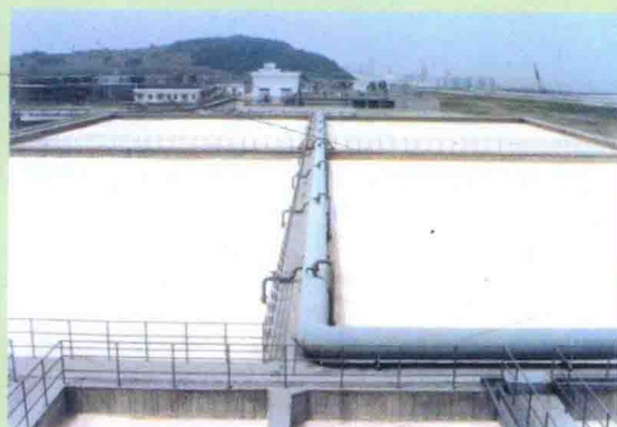
● 江苏金东纸业业有限公司 50000m 3 /d 废水处理工程
