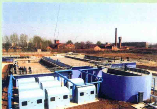
● 齐鲁——安替比奥制药有限公司 2400m 3 /d 高浓度废水处理工程
