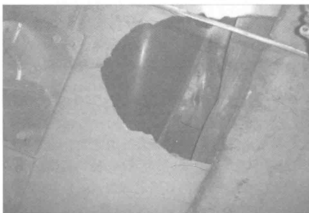
图 1-4 隧道衬砌空洞中可见防水板
