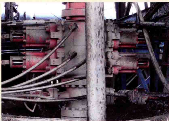
图 1-1-4 液压管线接口面向井架大门
