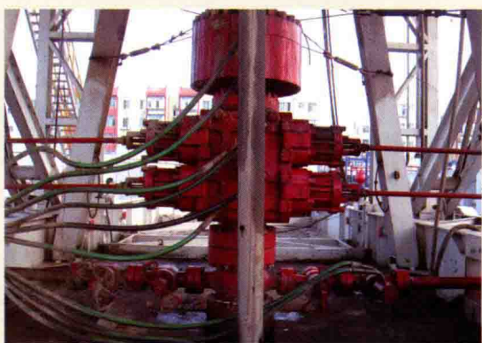
图 1-1-20 液压管线接口面向大门方向
