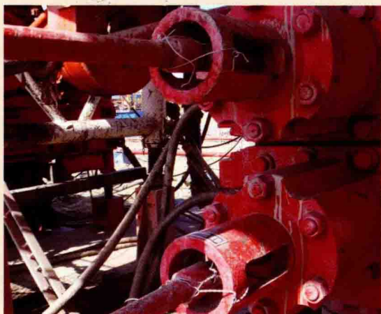
图 1-2-6 手动操作杆依靠铁丝固定
