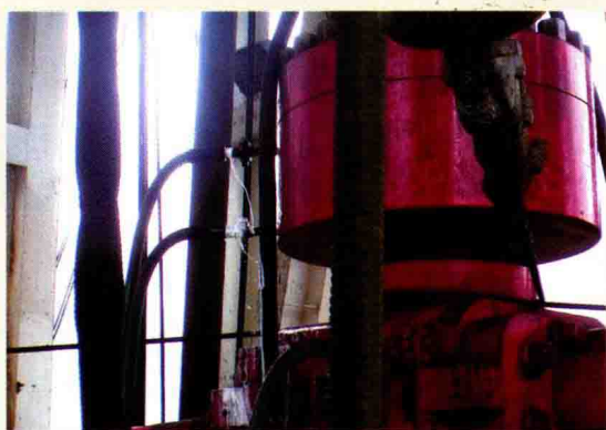
图 1-1-19 液压管线接口泄漏
