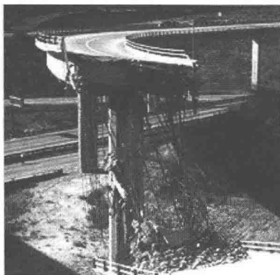
图 S-4 1994 年加州洛杉矶大地震中整跨塌落的公路大桥
