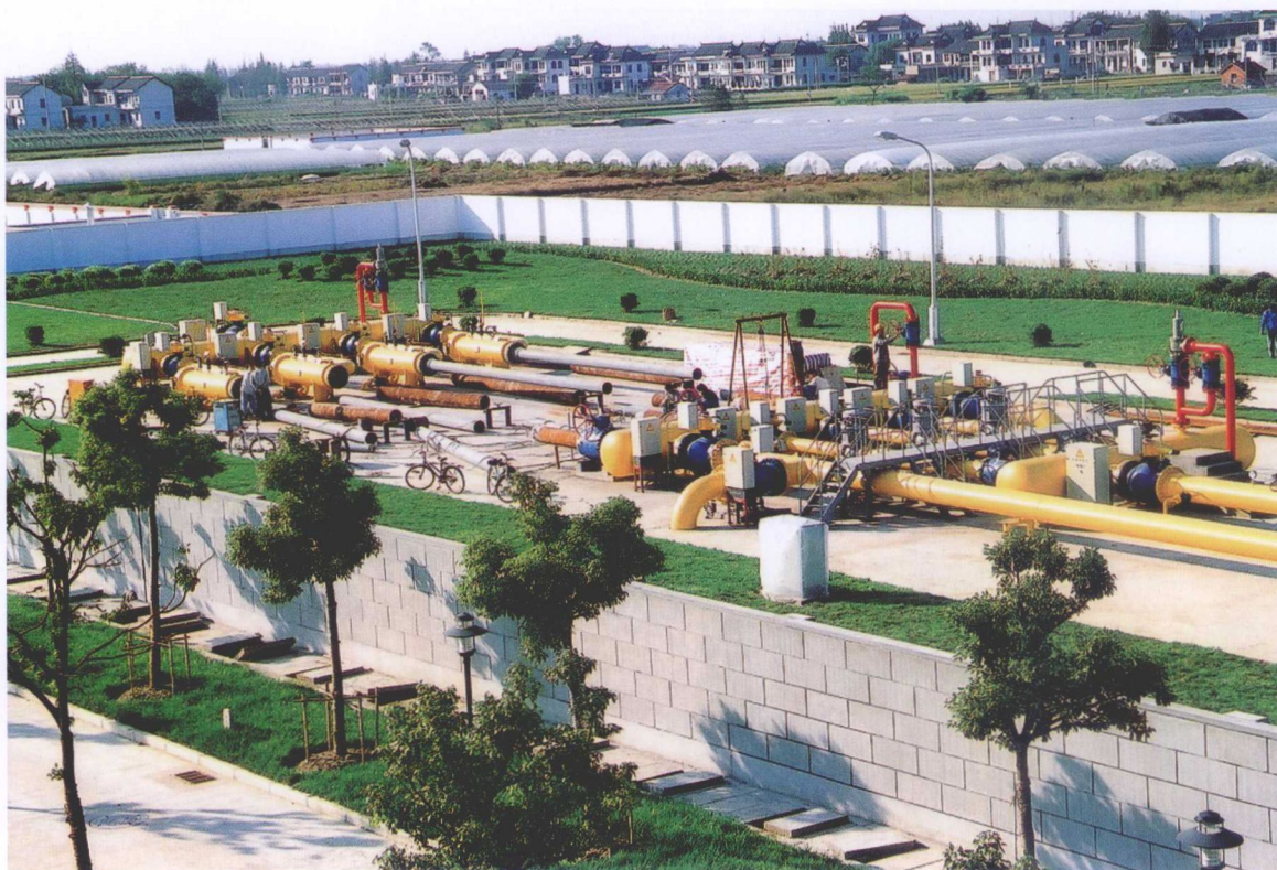
10月7日，西气东输工程的天然气从陕西抵达上海，11月20日起试供气。图为西气东输工程的终点站上海白鹤分输站
