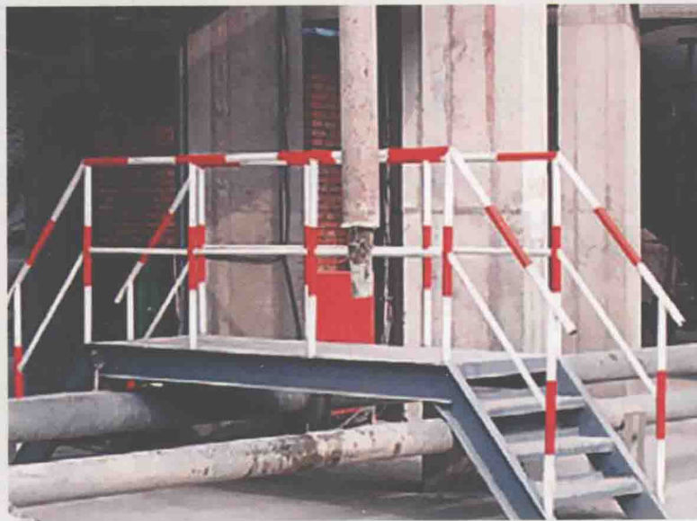
图 A-A03-01 跨越式安全通道
