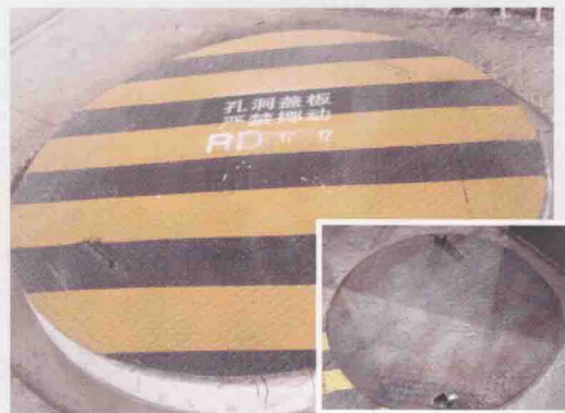
图 A-A05-02 主厂房孔洞盖板 2（小图：盖板限位）
