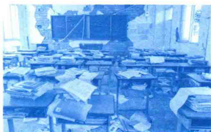
图 1-5 雅安地震中受损学校
