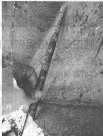
(b) 混凝土结构变形
