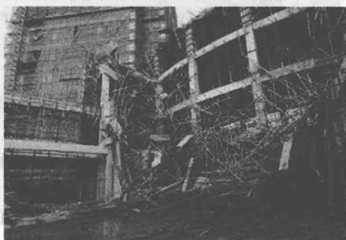
(d) 支模倒塌
