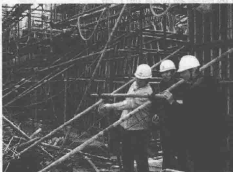
(c) 模板支设空间不足
