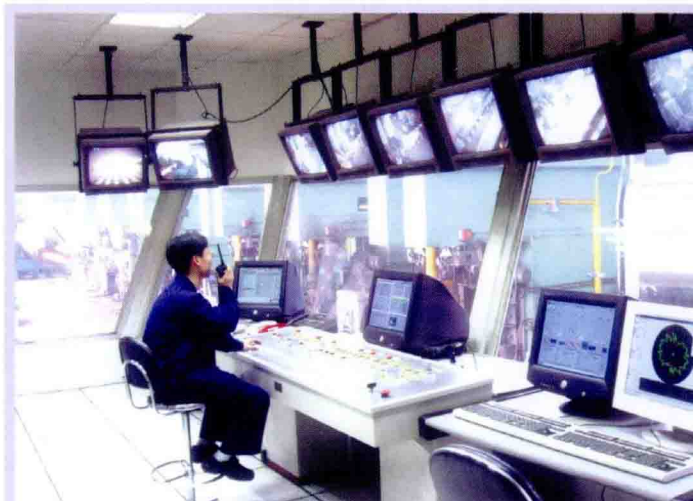
先进的自动化生产控制室
