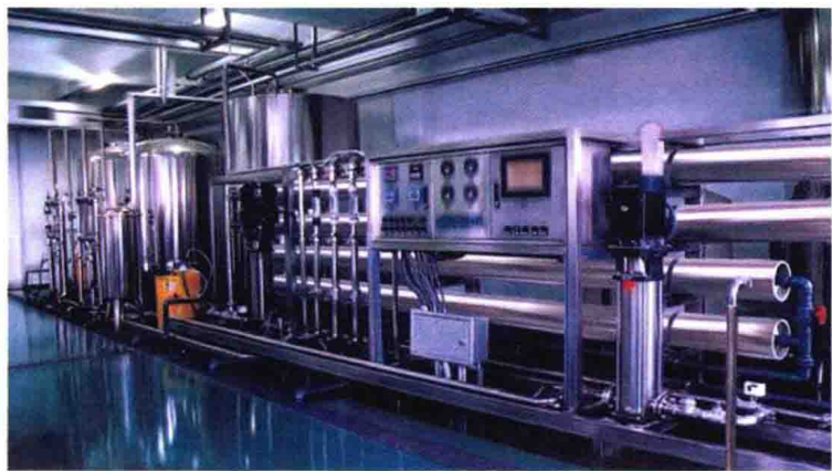
图 1-3 啤酒厂自动化水处理车间
