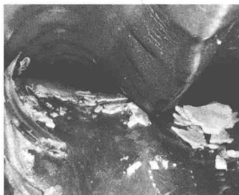
图 1.1-4 管道严重变形
