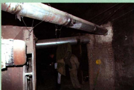
鸡舍供暖系统—输送管道
