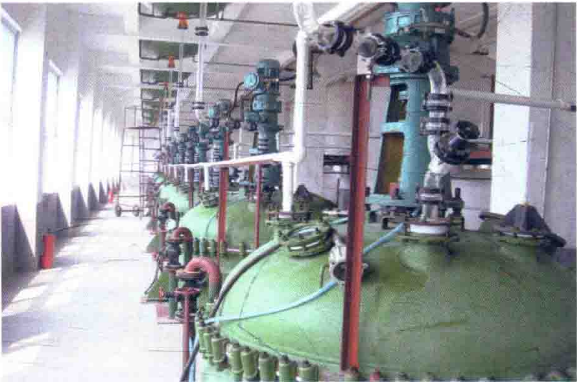
20世纪90年代寿光卫东化工有限公司阻燃剂生产车间
