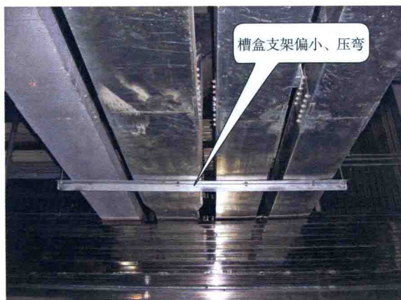
图1.1.1-2 槽盒与支架不匹配现场照片
