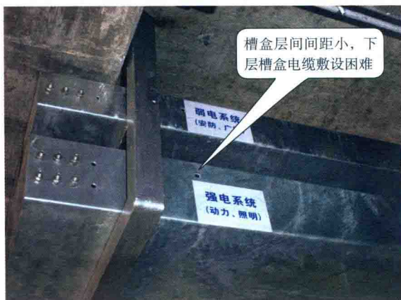
图1.1.1-1 水平敷设槽盒间距偏小现场照片
