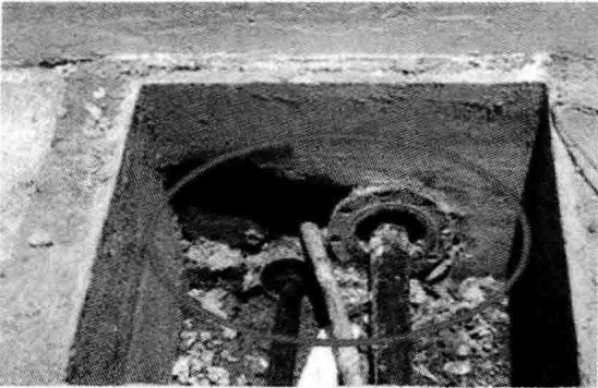
图 1.1-3 错误做法：同一处电缆管路封堵不一致
