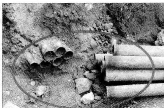
图 1.1-10 错误做法：室外电线保护管管口未处理
