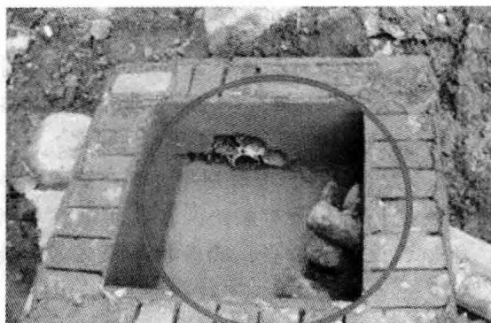
图 1.1-9 错误做法：弱电外管管口未处理，易造成电线损伤
