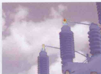
变压器接头检测
