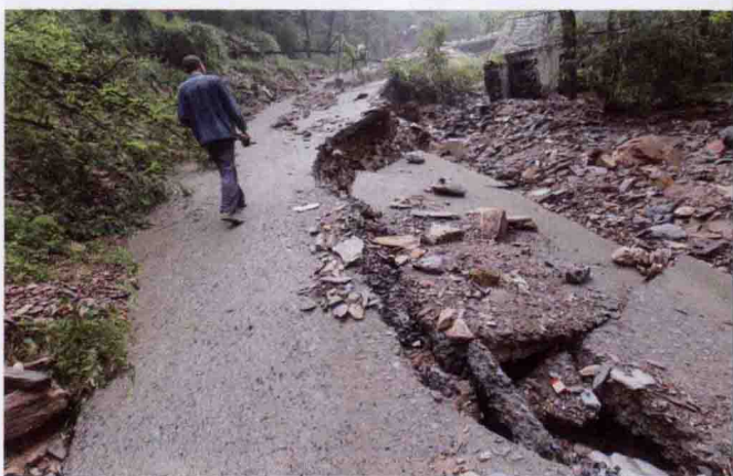
"7·21" 特大自然灾害损毁道路情况
