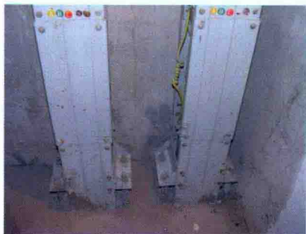
图15 电气竖井内插接母线槽被污染
