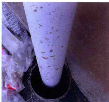
图5 出屋面防水钢套管管径过大，防水封堵较困难
