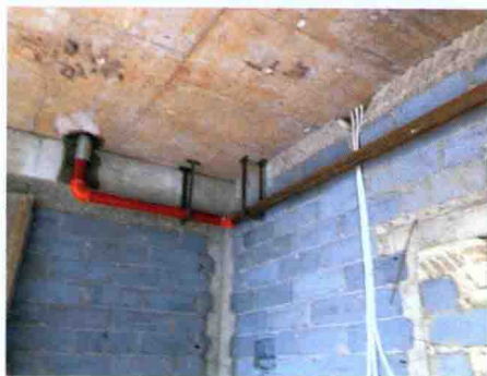
图17 焊接钢管及管子吊架事前未进行除锈和防腐处理
