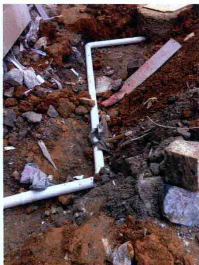
图21 室外排水管道未走最近距离，中间拐弯过多易形成堵塞
