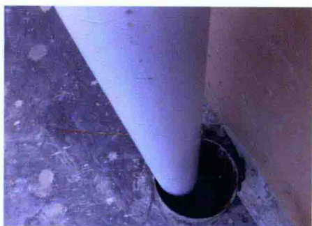
图6 出屋面防水钢套管与排水管严重偏心，且套管过大
