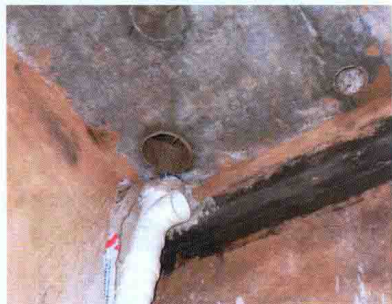
图3 室内排水立管穿楼板位置与预埋洞口位置严重偏离
