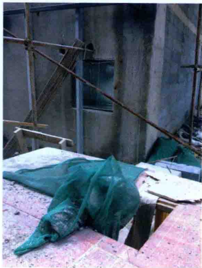
图18 外墙石材型钢挡住排风口
