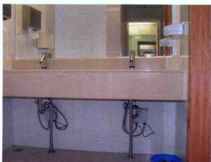
图16 洗手盆台子下方进水配件不规整
