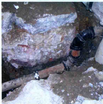
图25 埋地铸铁排水管未做防腐处理
