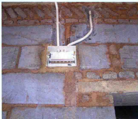
图8 暗配电线管进箱未加锁扣
