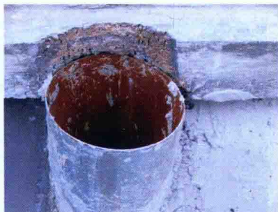
图2 出屋面防水钢套管靠女儿墙过近，破坏下方滴水线
