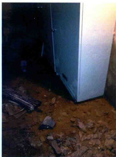
图29 配电柜安装地面严重积水
