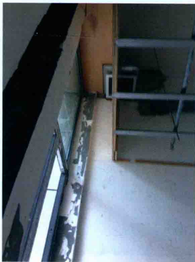
图19 吊顶窗帘盒侧板挡住风口
