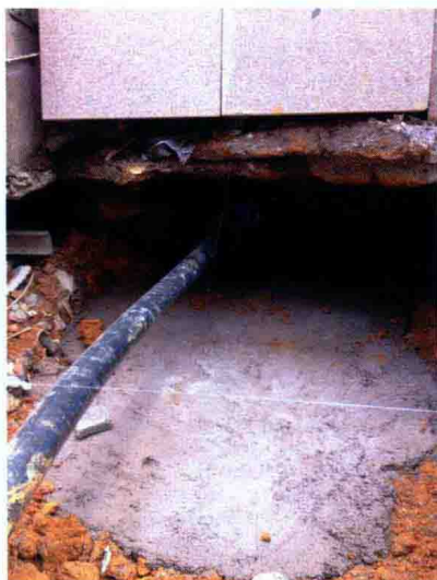
图20 进水阀门安装过深，将来难于检修维护
