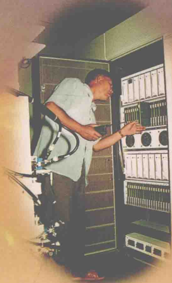
载波机务员正在排除障碍
