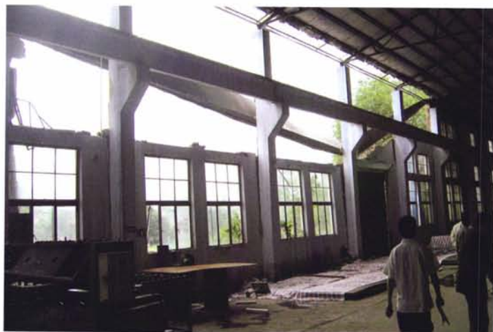
绵阳三力股份新皂公司受损的车间
