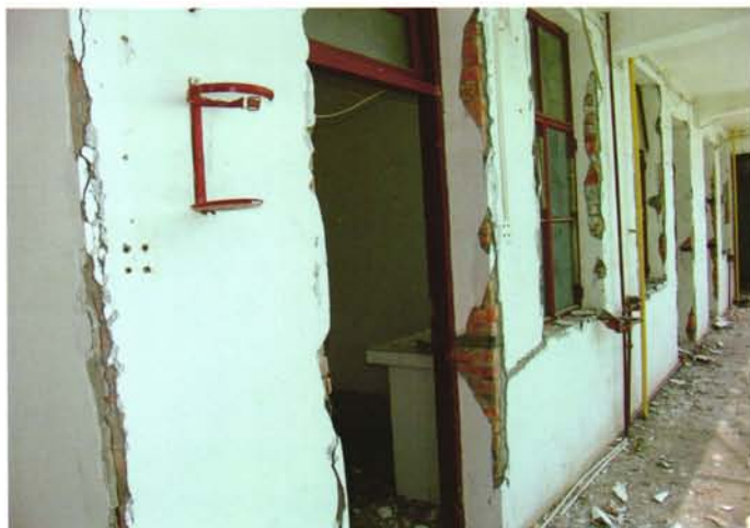
绵阳市人民医院受损房屋
