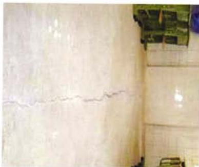
石塘小学教学楼地面地震裂缝
