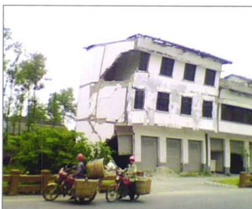
青义镇受损农房扭曲变形
