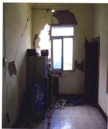
青义广播电视站受损的站房
