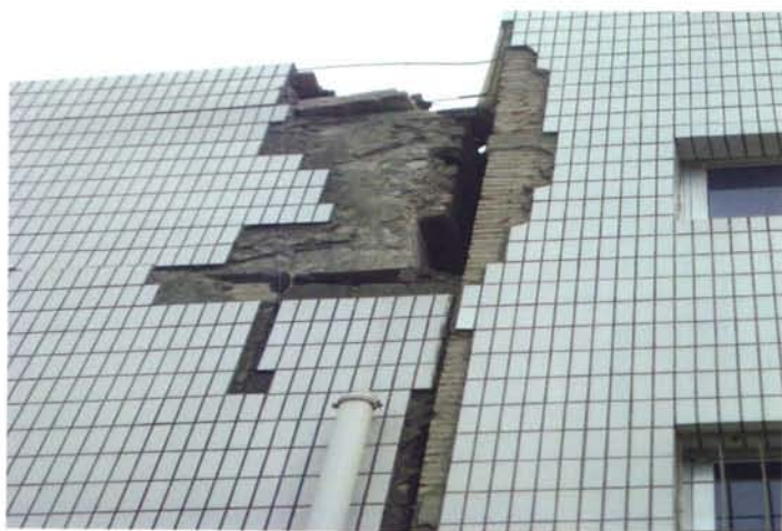
区法院办公楼受损开裂
