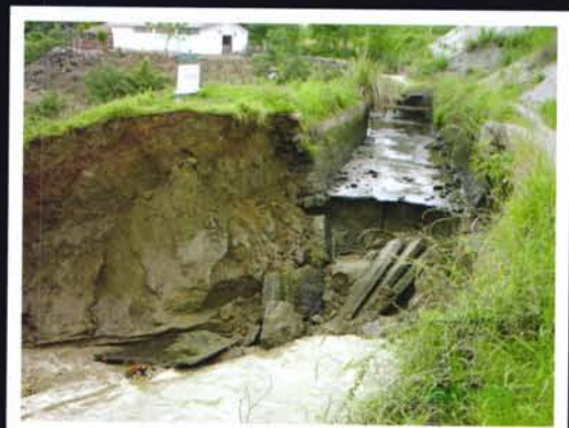
区水务农机局龙西堰管理所龙门镇回龙寺渠段 大决口
