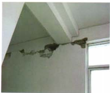
绵阳九中教学楼·琢玉楼楼道内侧受损情况
