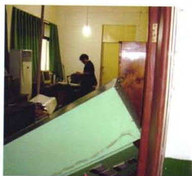
区广电局机关受损的设备设施
