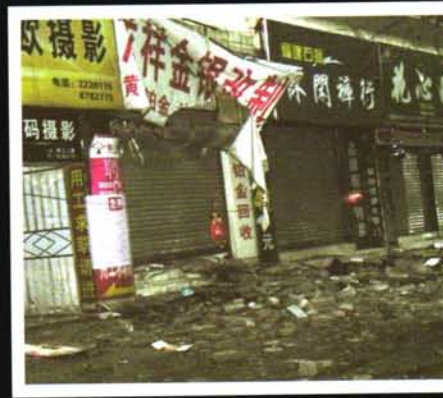
城区涪城路受损店铺
