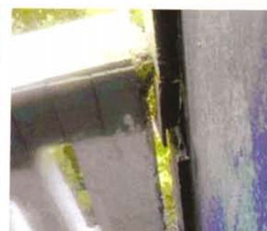
金峰小学楼道走廊与墙体已经分离
