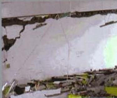
花园实验幼儿园严重受损的教学楼
