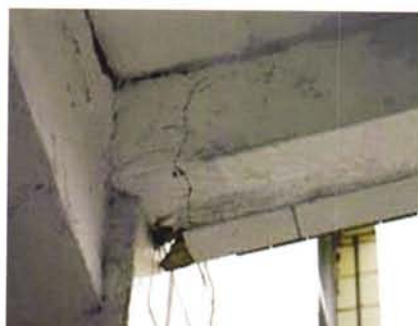
警钟街小学楼房横梁断裂
