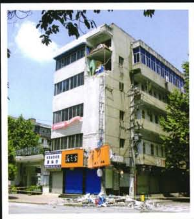
区公安分局受损的办公楼一角
