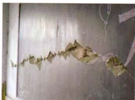
绵阳市跃进北路学校一受损墙体
