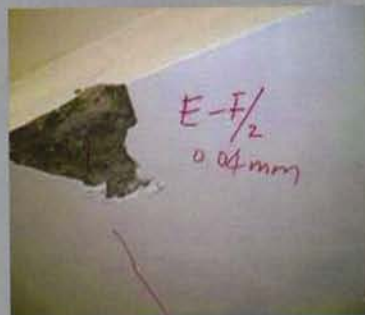
公园路幼儿园主梁贯穿裂缝
