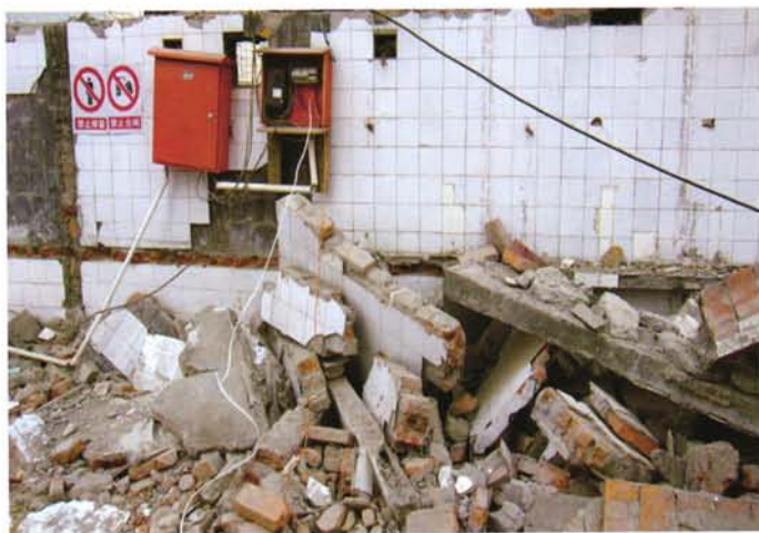
龙门镇卫生院受损的配电房
