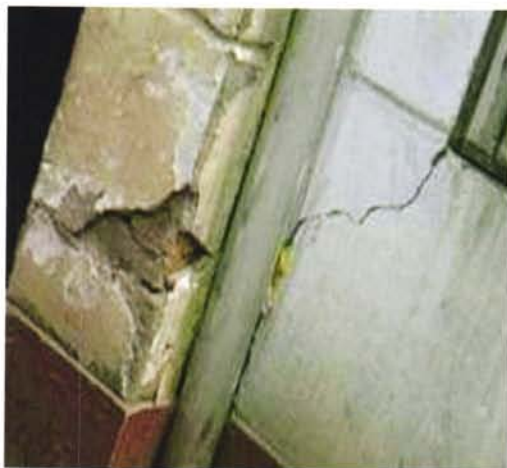
关帝中学教学楼西侧承重墙随地基下陷而开裂
