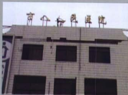
绵阳市第八人民医院受损的大楼
