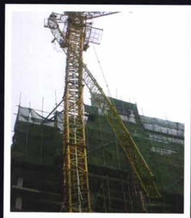
城区受损停工的在建工地
