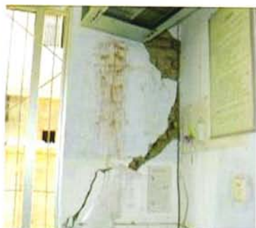
青义小学受损的教学楼
