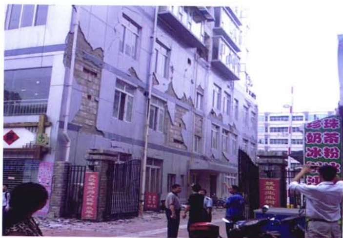
区检察院受损的办公楼外墙
