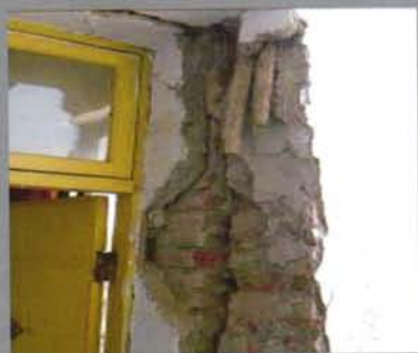
区特殊教育学校受损的办公楼及学生寝室
