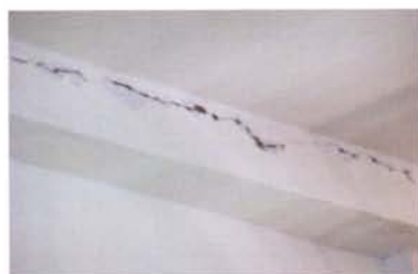
吴家中心卫生院受损房屋
