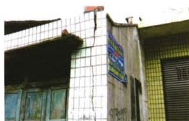
丰谷中心卫生院受损房屋
