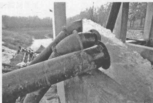
图 1.2 机电排灌泵站排涝现场
