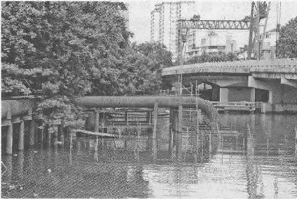
图 1.3 某临时调水泵站
