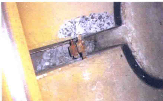
图 1—2 CRTS I 型轨道板纵向预应力钢棒断裂
