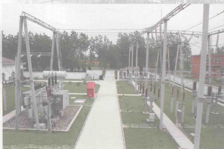
肥东梁元 35 千伏变 电所
