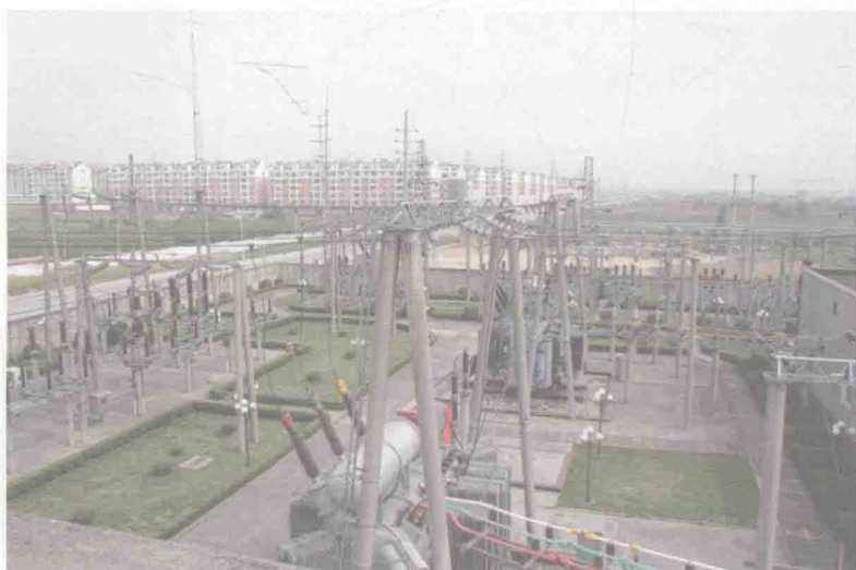
肥东店埠 110 千伏变 电所
