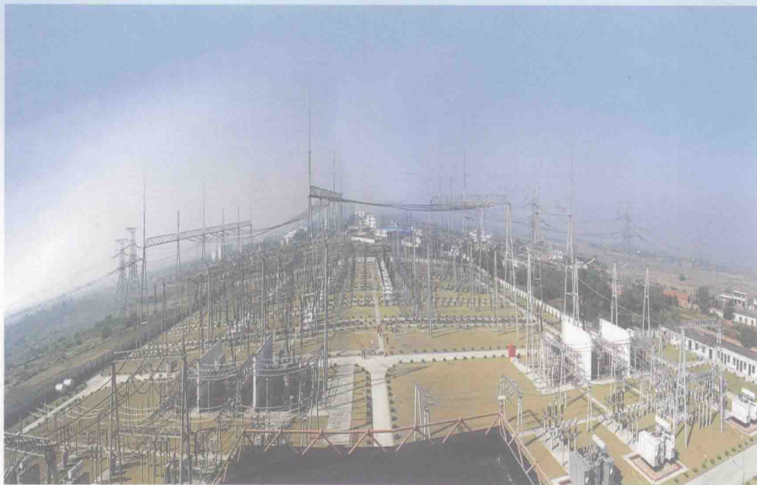
肥西 500 千伏变电所
