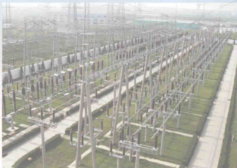
振宁 220 千伏变电所
