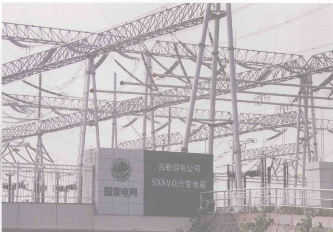
众兴 500 千伏变电所
