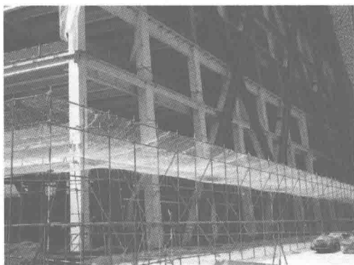
图 3-17 首层安全网防护
